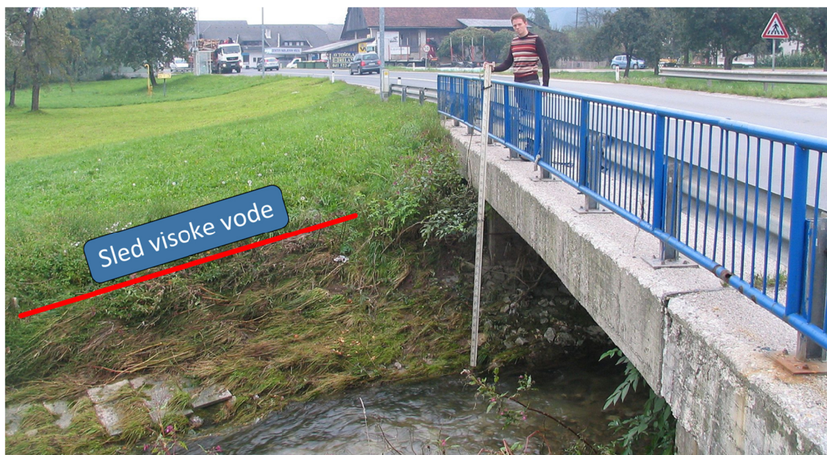
Slika 2: Sled visoke vode 19.9.2010, fotografija posneta 24.9.2010 (FOTO: G. Novak)
